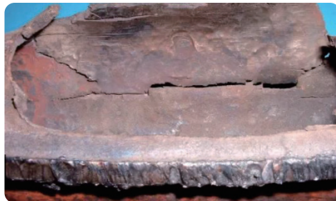
<그림 10> 고온 수소침식으로 보일러 튜브에 균열
