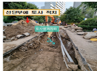
• 굴착 선단부 토사적치 또는 건설기계로 인한 하중증가
