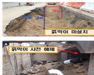
• 흙막이 미설치 또는 설치 불량
